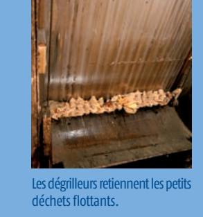
Les dégrilleurs retiennent les petits déchets flottants.
