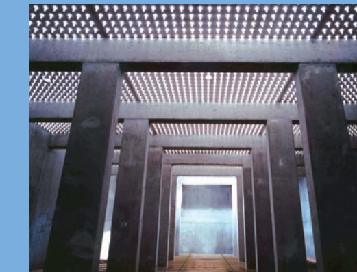
Vue intérieure d'un biofiltre. Le bassin contient les billes de biostyrène® sur lesquelles se fixent les bactéries. L'eau traverse le biofiltre de bas en haut et ressort, épurée, par les crépines du plafond.
