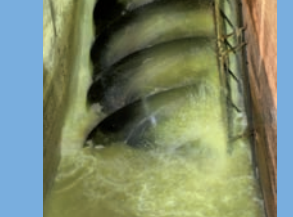
Trois vis d'Archimède relèvent les eaux vers les bassins de pré-traitement.
